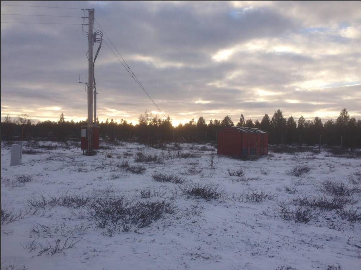
Figur 50: Bilde av lokal trafostasjon.
