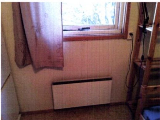
Bilde nr 41 viser typisk panelovn.
