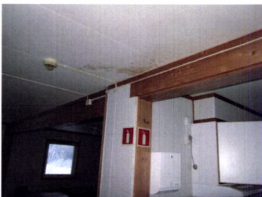
Bilde nr 22 viser merker i tak på felleskjøkken.
