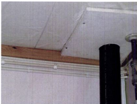
Bilde nr 20 viser fukt ved rørgjennomføring.
