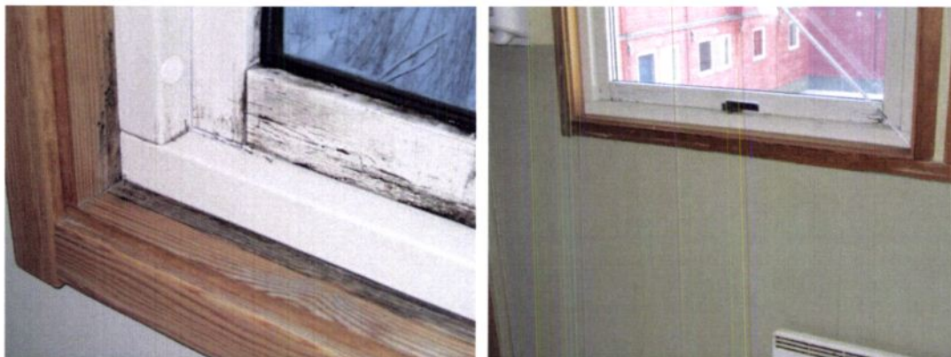
Bilde nr 29 og 30 viser vanlig overflatesopp på typiske vinduer.
