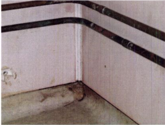
Bilde nr 13 viser flekker og missfarging i dusj.
