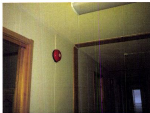
Bilde nr 43 viser klokke for brannalarm.
