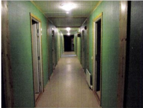
Bilde nr 9 viser rehabilitert del etter vannskade
