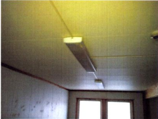
Bilde nr 39 viser lysarmatur i fellesrom.
