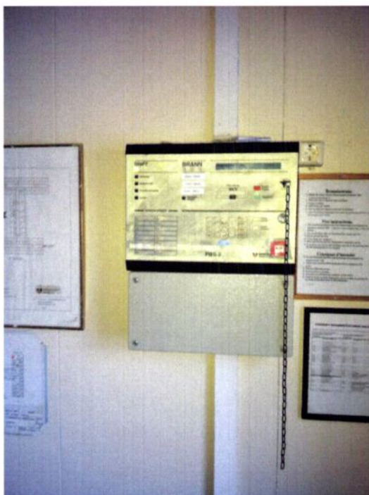
Bilde nr 42 viser brannalarmsentral.
