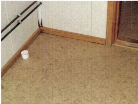
Bilde nr15 viser vannskade under åpne vannrør.
