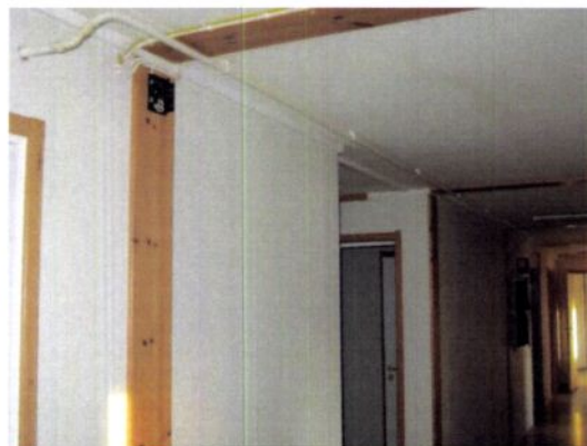
Bilde nr 21 viser skjolder i takplater.
