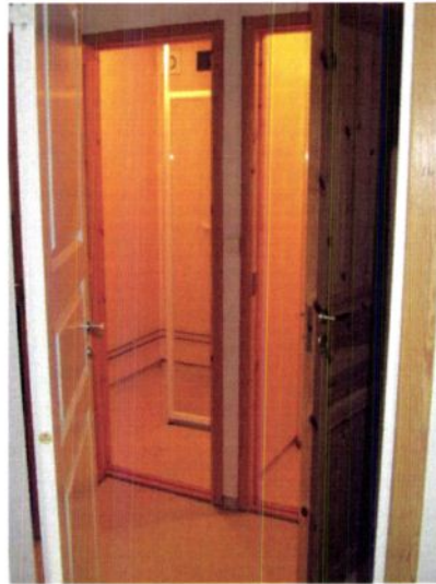
Bilde nr 10 viser typisk våtrom med dusj.
