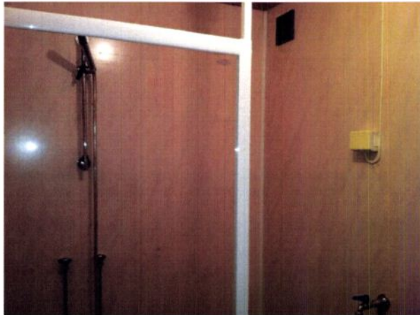
Bilde nr 34 viser strømuttak i dusjsone.
