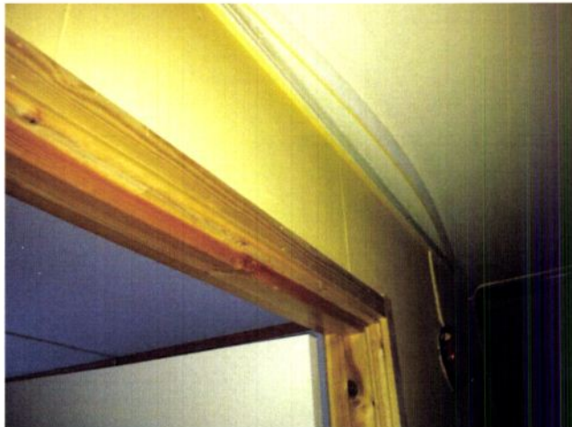
Bilde nr 35 viser løs kabel i gangtak.
