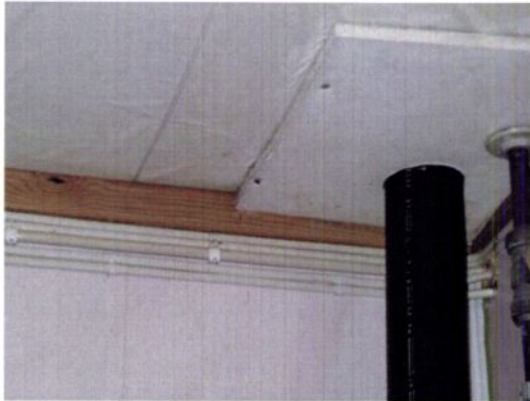
Bilde nr 20 viser fukt ved rørgjennomføring.
