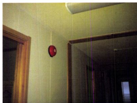
Bilde nr 43 viser klokke for brannalarm.
