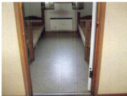
Bilde nr 32 viser merke etter panelovn på rom.
