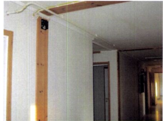
Bilde nr 21 viser skjolder i takplater.
