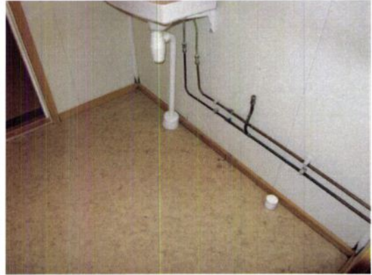
Bilde nr 14 viser vannskade bak vask.
