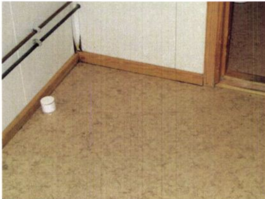
Bilde nr15 viser vannskade under åpne vannrør.
