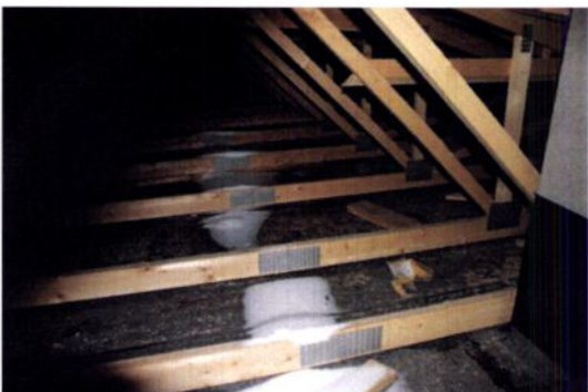
Bilde nr 23 viser innfyk på kaldloft.
