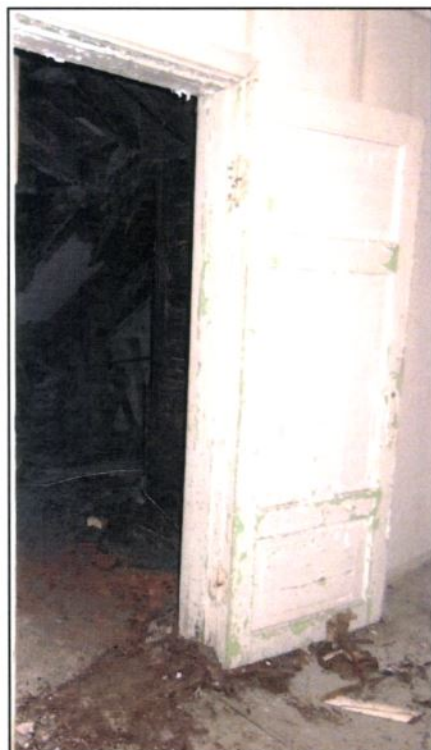
Dette rommet er kun besiktiget på avstand fra rom 205 pga sikkerhetshensyn
